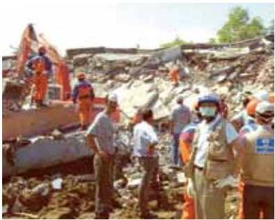
1999年、トルコの地震災害のビル倒壊現場での救護活動。
